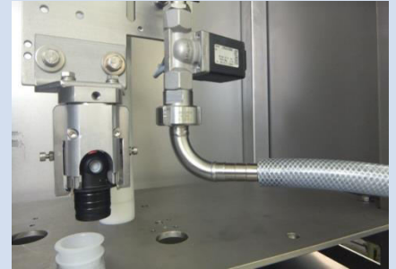
Raccord de nettoyage
