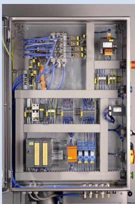
Armoire de commande
